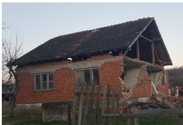
Slika 7. Građevinski otpad nastao zbog urušavanja djelovanjem potresa
